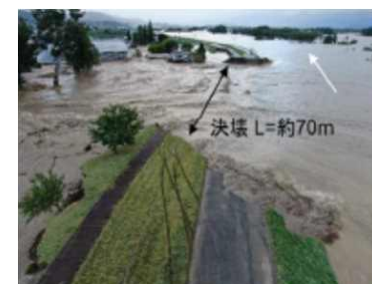
千曲川における浸水被害 (長野県長野市穂保地先)
