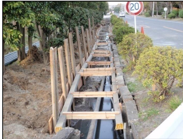
崩壊拡大防止措置(17日)
