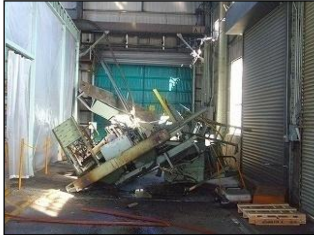
遊休クレーンの落下
