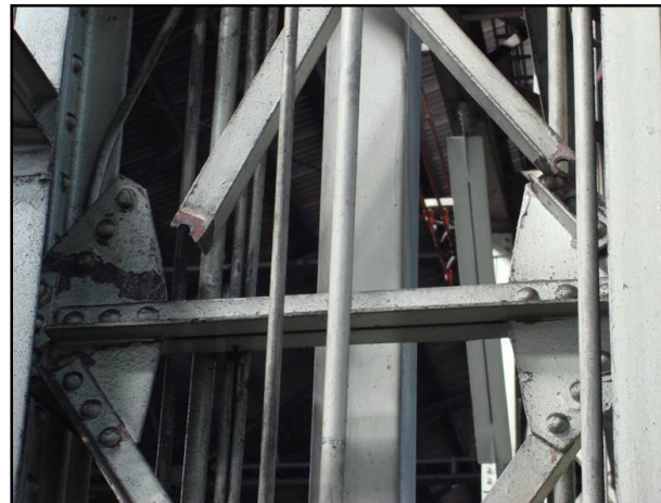
建屋の柱が破断
