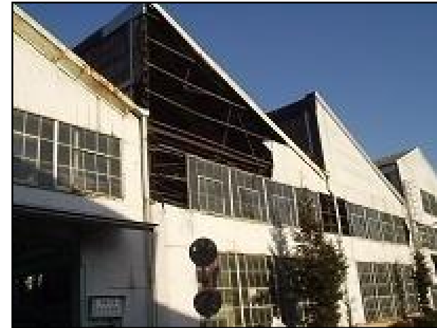
工場の壁が脱落
