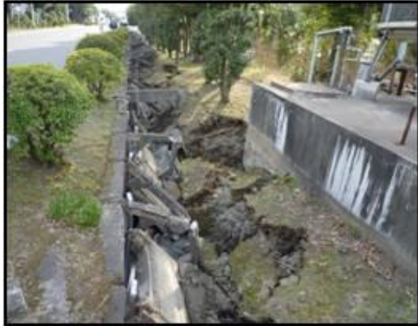
中央排水溝の崩壊(11日)
