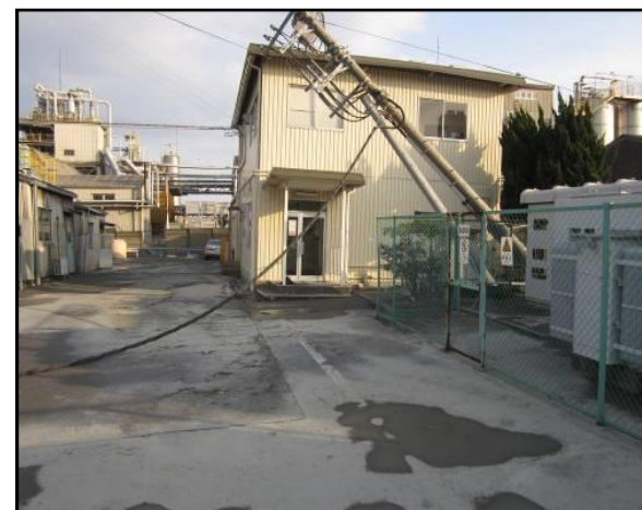
液状化で鉄柱倒壊
